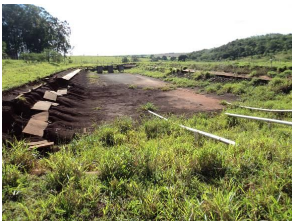
Figura 05. Vista da segunda lagoa de tratamento do Distrito de Santo Antonio do Paranapanema
