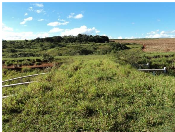
Figura 06. Vista do talude de divisa das lagoas de tratamento do Distrito de Santo Antonio do Paranapanema
