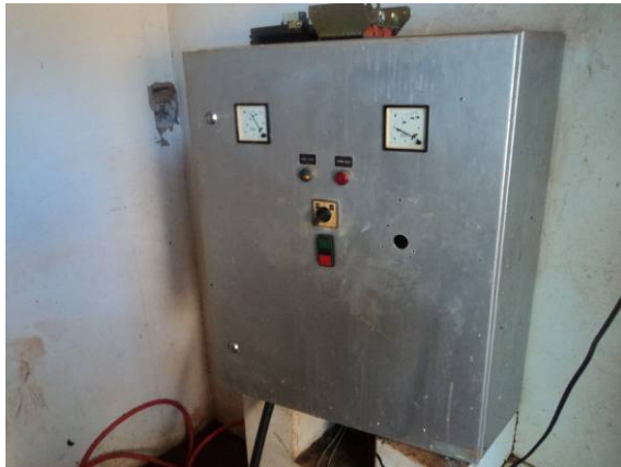
Figura 80. Vista do Painel Elétrico
