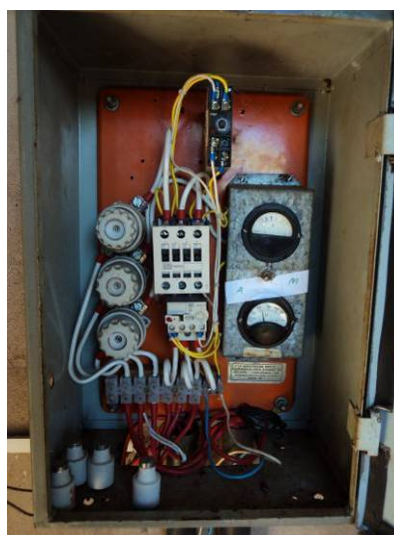
Figura 119. Vista do Painel Elétrico do Distrito de Frutal do Campo
