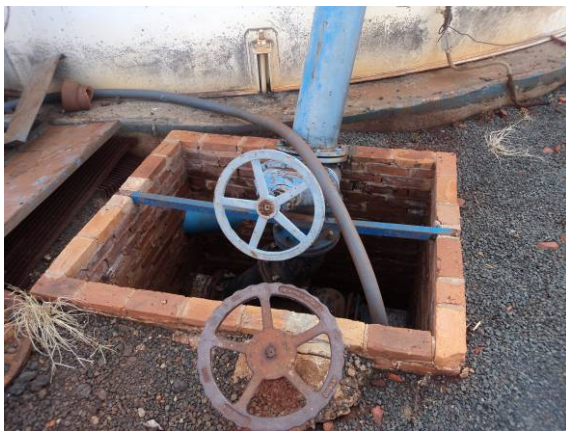
Figura 37. Vista da chegada da tubulação da Elevatória no sistema de reservação Central
