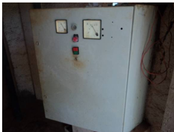
Figura 77. Vista do Painel Elétrico
