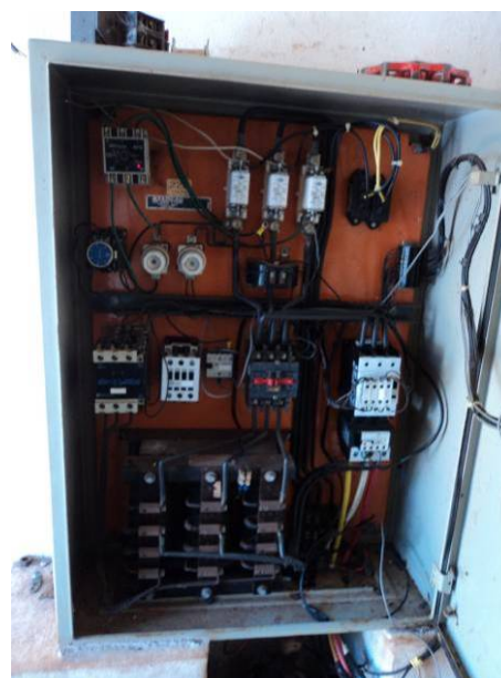
Figura 115. Vista do Painel elétrico do Distrito Frutal do Campo
