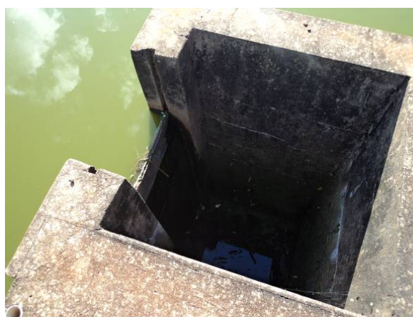
Figura 171. Vista da caixa saída do tratamento de esgoto do Distrito de Frutal do Campo
