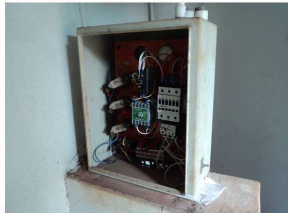
Figura 93. Vista do Painel Elétrico
