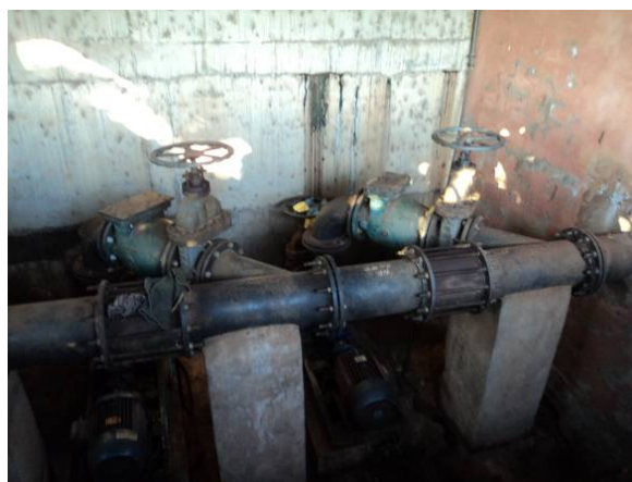
Figura 151. Vista do conjunto de recalque da Estação Elevatória Escola Agrícola
