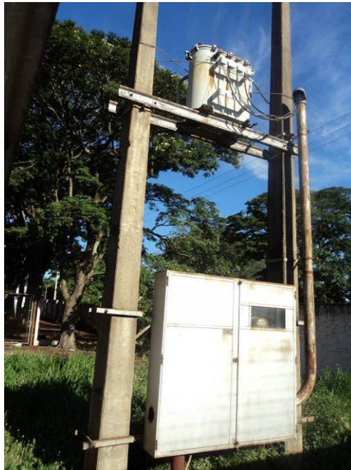
Figura 65. Vista Transformador existente no Poço 06
