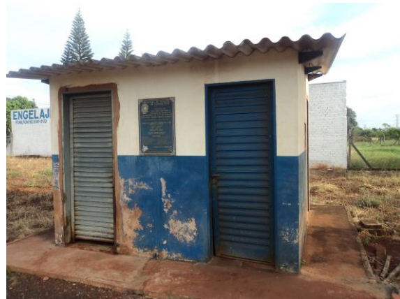
Figura 97. Vista do Abrigo do Painel Elétrico
