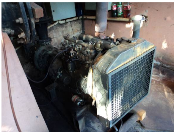
Figura 146. Vista do gerador existente da Elevatória de Esgoto Santa Terezinha
