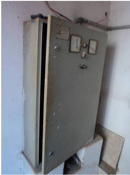
Figura 41. Vista do Painel Elétrico
