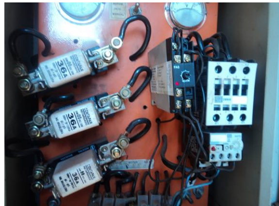
Figura 73. Vista do Painel Elétrico
