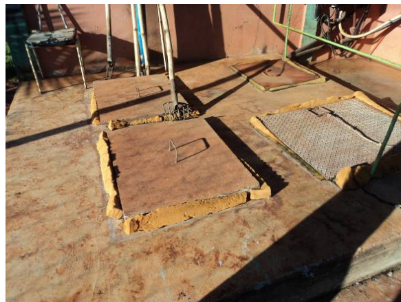
Figura 153. Vista do tanque de sucção da Estação Elevatória Jardim Alvorada
