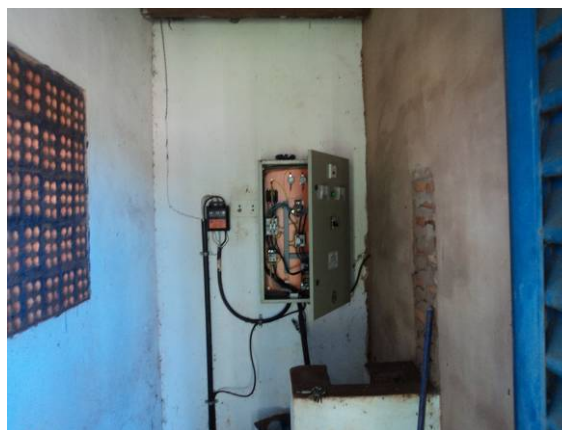
Figura 64. Vista do Painel Elétrico
