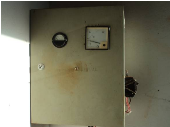
Figura 98. Vista do Painel Elétrico
