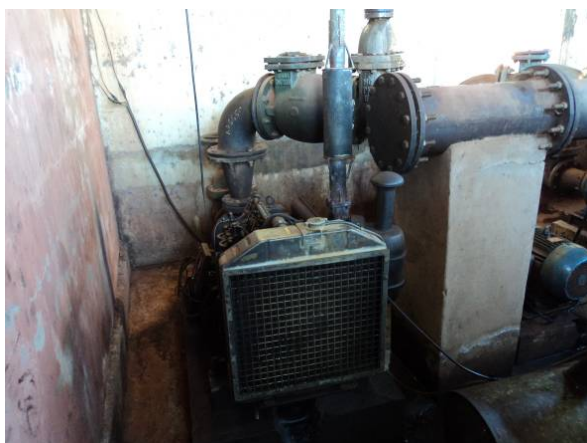
Figura 150. Vista do gerador da Estação Elevatória Escola Agrícola
