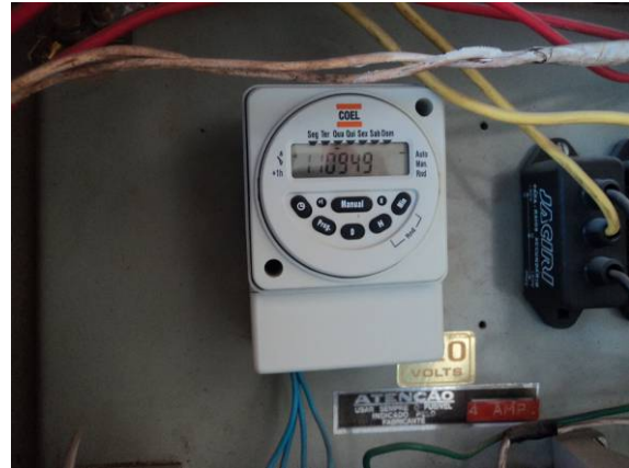
Figura 42. Vista do Painel Elétrico
