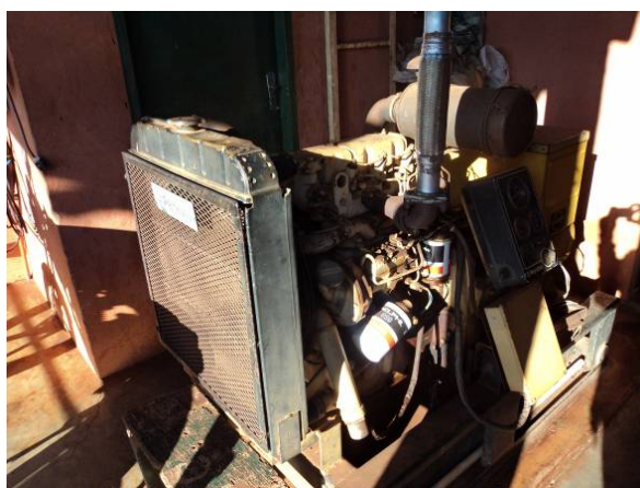
Figura 154. Vista do gerador da Estação Elevatória Jardim Alvorada
