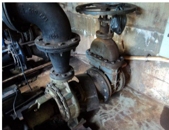
Figura 147. Vista bomba de recalque da Elevatória de Esgoto Santa Terezinha
