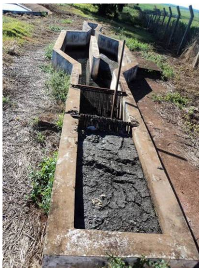
Figura 166. Vista do tratamento preliminar da ETE do Distrito de Nova Alexandria
