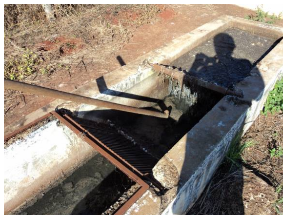
Figura 167. Vista do gradeamento da ETE do Distrito de Nova Alexandria
