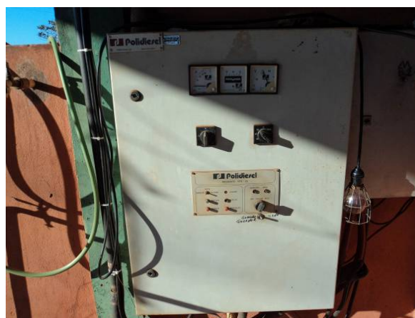
Figura 155. Vista do Painel elétrico da Estação Elevatória Jardim Alvorada
