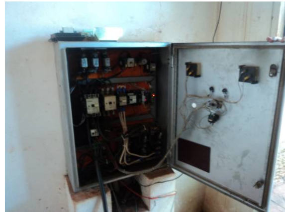
Figura 81. Vista do Painel Elétrico
