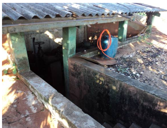
Figura 149. Vista da casa de máquinas da Estação Elevatória Escola Agrícola
