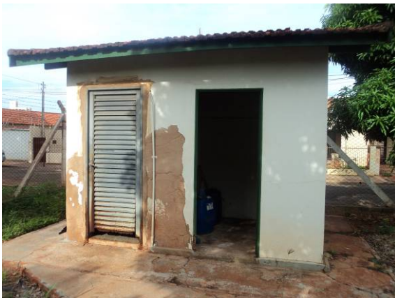
Figura 92. Vista do Abrigo do Painel Elétrico
