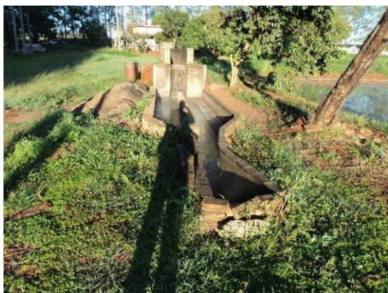
Figura 142. Vista do tratamento preliminar da ETE da sede do município
