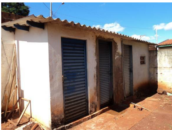
Figura 114. Vista do abrigo do Painel elétrico do Distrito Frutal do Campo
