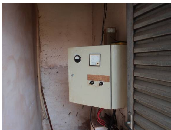
Figura 111. Vista do Painel elétrico
