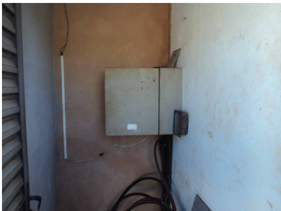
Figura 47. Vista do Painel Elétrico
