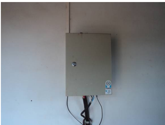
Figura 104. Vista do Painel Elétrico
