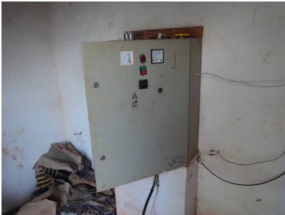
Figura 53. Vista do Painel Elétrico
