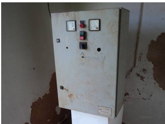
Figura 86. Vista do Painel Elétrico
