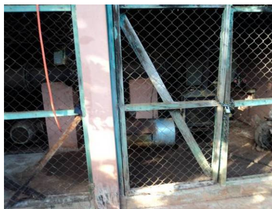
Figura 145. Vista da casa de máquinas da Estação Elevatória Santa Terezinha
