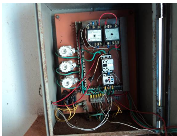
Figura 127. Vista do Painel elétrico
