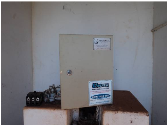
Figura 72. Vista do Painel Elétrico
