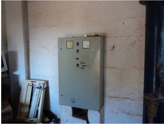
Figura 59. Vista do Painel Elétrico
